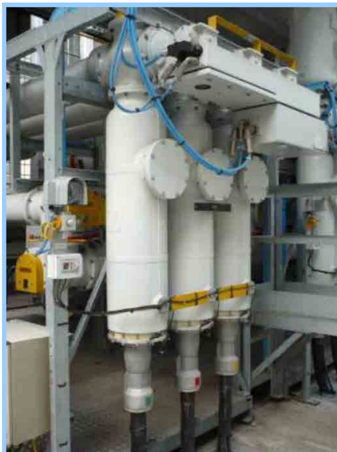
Sottostazione AT 130 kV Moline
